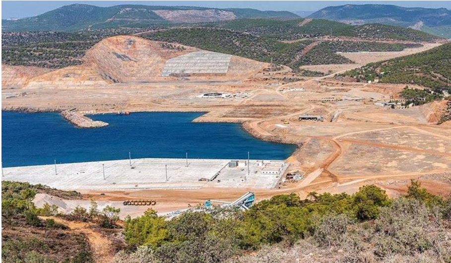
Akkuyu NGS reaktör binasının taban yapımının 2019'daki durumu ve çevresi (Resim: https://www.artigercek.com/ ).
