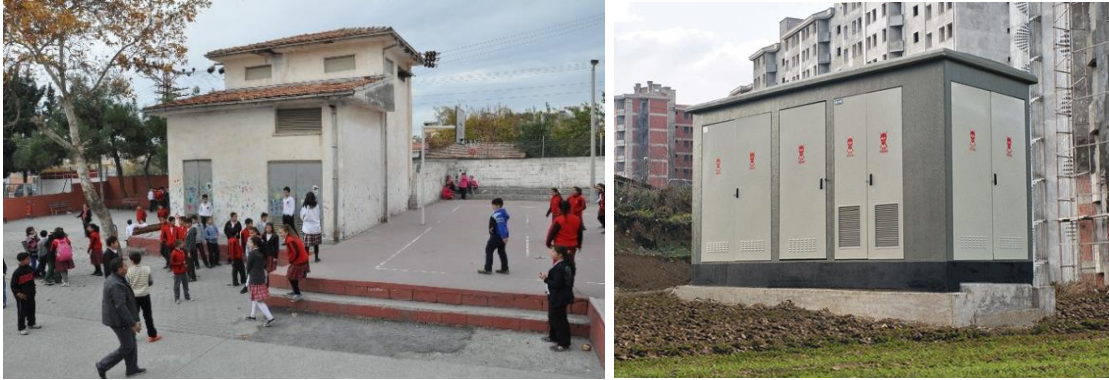
Resim 3, 4: Okul bahçesindeki trafo çevresinde oynayan çocuklar ve yüksek binaların önüne kurulmuş trafolar
