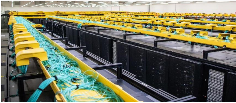
Şekil 3: Server’lerdeki kablo yoğunluğu
