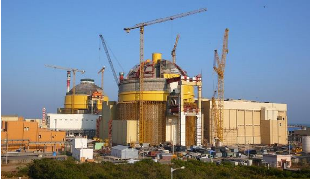
Rusya'nın Hindistan Kundakulam'da yaptığı reaktör binasının kalın duvarlı dış yapısı (Koruma Kabı/ Containment), Şekil : IAEA (Akkuyu'da yapılmakta olan reaktörlerin benzeri)
